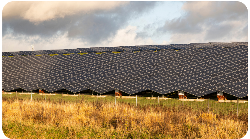
Parque Solar Paracatú - MG
